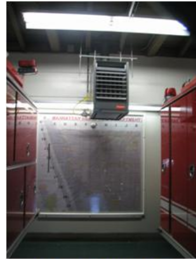
Fire Truck Bay / Exhaust Fan
